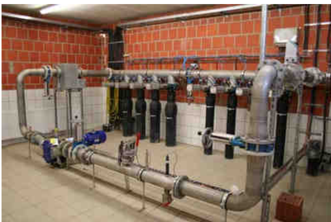
Pompownia z pomiarem przepływu i zasuwaniami automatycznymi
