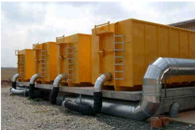
Biogazownia Lelbach: suszenie trocin
