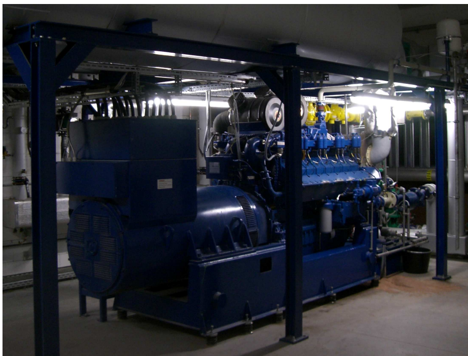
Fot 1 Kogenerator (archiwum autora)
