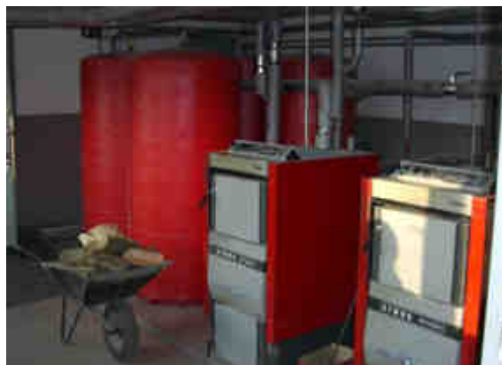
Kotłownia na biomasę
